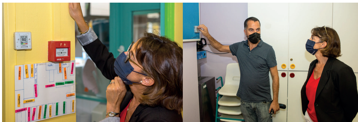
Pose des capteurs de CO2 à l'école Joseph-Clouet et à la crèche des Laitières, le 15 septembre 2021, en présence du maire Charlotte Libert-Albanel. © Thierry Guillaume / Ville de Vincennes
